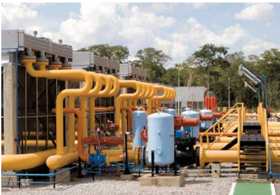
Planta de compresión de gas, estación Chiquitos | Fotografía: Walter Ridder
